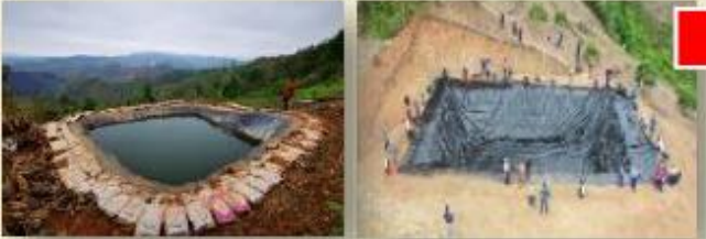
บ่อกักเก็บน้ำ + ระบบกระจายน้ำ
